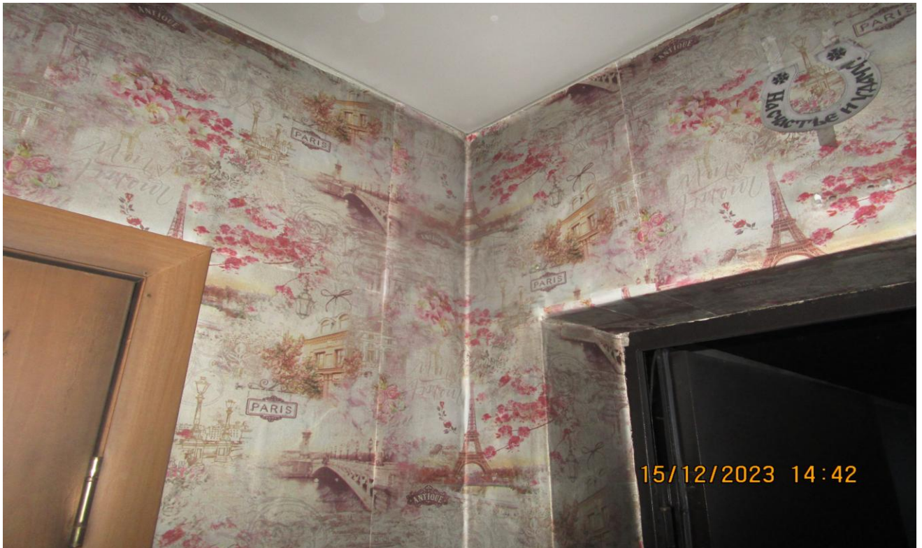
Фото №4. Закопчение продуктами горения поверхности стен, образование плесени на поверхности конструкций.
