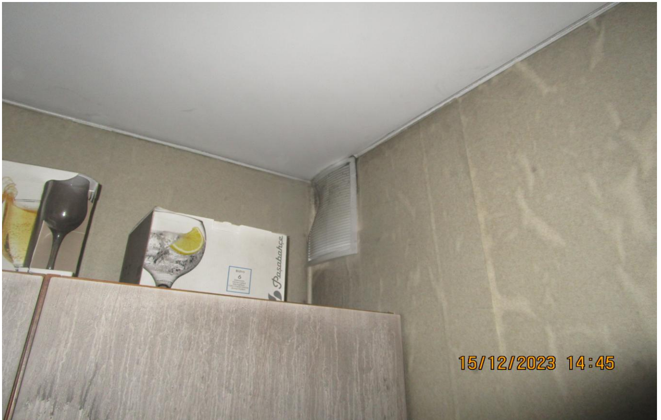
Фото №6. Оплавление вентиляционных решеток, закопчение продуктами горения поверхности стен, образование плесени на поверхности конструкций.
